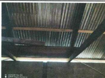
Foto 2: Techo y costaneras a sustituir en la cocina
