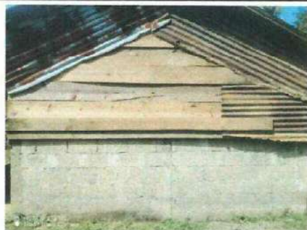
Foto 1: Madera a sustituir en la cocina
